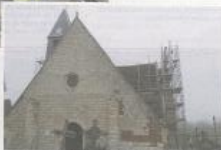
La première tranche de travaux a débuté fin 2022. Elle devrait encore durer un peu plus d'un an.
